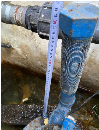
Aknán belüli kútkarimához csatlakozó gáztalanító szellőzőcső
